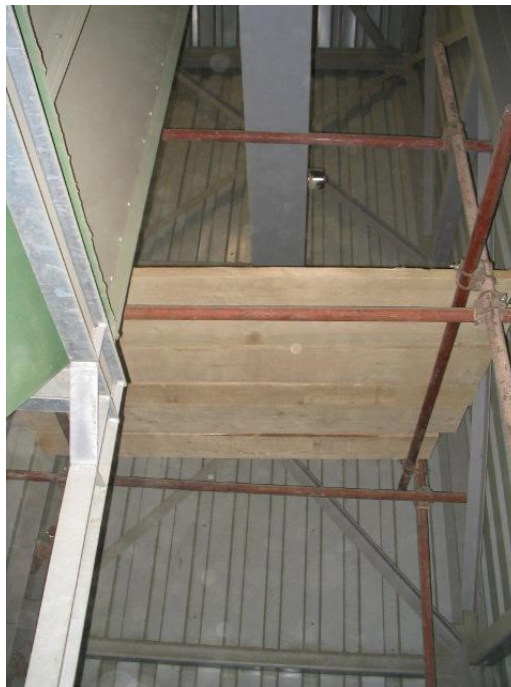
Slika 9. Memo mesto na izlazu iz vrećastog filtera na presipnoj stanici u presipnoj kuli
