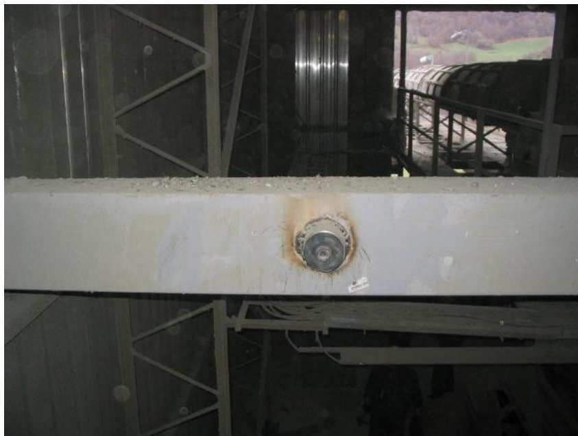
Slika 12 - Merno mesto na izlazu iz vrećastog filtera na presipnoj stanici na silosu klinkera
