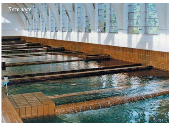
Постројење Беле воде (Извор: www.bvk.rs )
